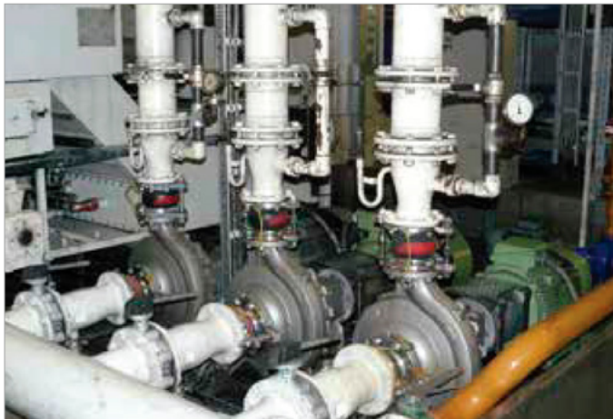
これらの3つのMWFポンプは、費用対効果の確認のためにパイロットプロジェクトで取り上げられ、現在も稼働を続けています。
