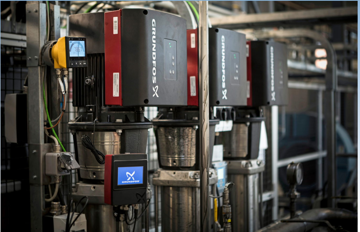
Grundfosin CRE-pumppuja ja Condition Monitor CMU -järjestelmää käytetään BIRNin CED-pinnoitus- ja pintakäsittely-yksikön säiliössä.
