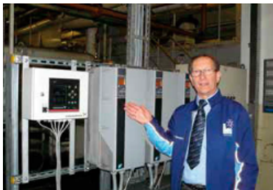
“Solo la tecnología de control recién instalada es capaz de reconocer cuándo las máquinas herramienta necesitan menos o ningún lubricante de refrigeración y, por lo tanto, las bombas se pueden detener por completo” (Paul-Gerhard Römermann, responsable de energía de la planta de Braunschweig de Volkswagen AG).
