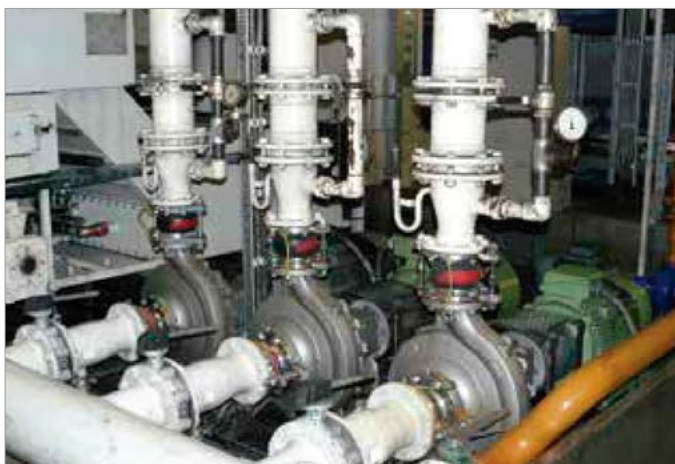
Tato tři čerpadla MWF byla středem pozornosti během pilotního projektu „Pump Audit“ – díky své hospodárnosti zůstanou v provozu.
