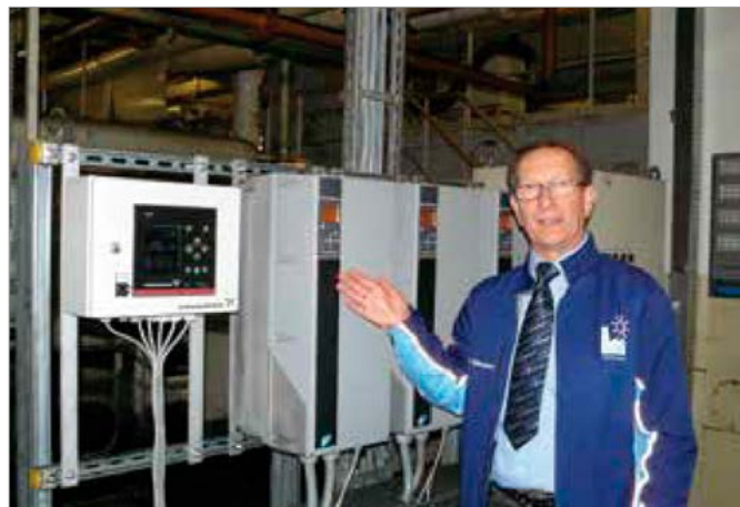
„Pouze nově instalovaná řídicí technika dokáže rozpoznat, kdy obráběcí stroje potřebují méně nebo vůbec žádnou chladicí emulzi, a proto lze čerpadla zcela zastavit.“ (Paul-Gerhard Römermann, energetický specialista závodu Volkswagen AG v Braunschweigu).
