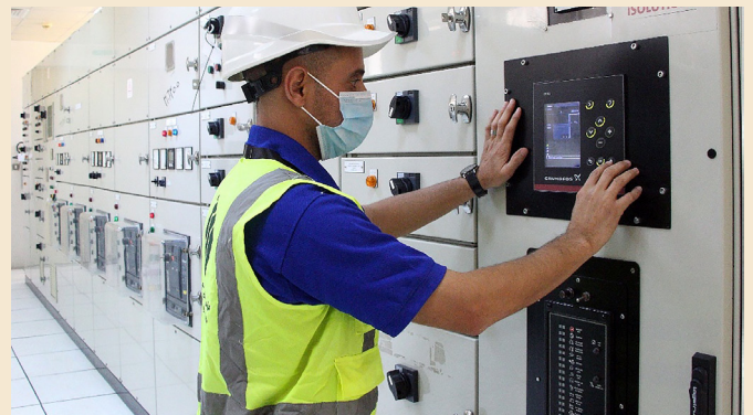
Mit einer Aufrüstung der Pumpenanlage, Dedicated Controls und einem Fernverwaltungssystem von Grundfos konnte die RAKWA 20 % Energie und 12 % der Gesamtbetriebskosten einsparen.
