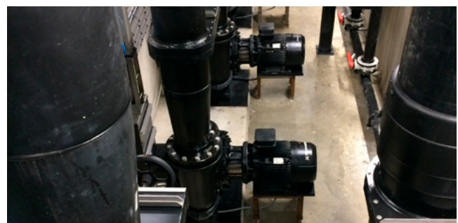
Instalación de bombeo GRUNDFOS en Kingfish Zeeland
